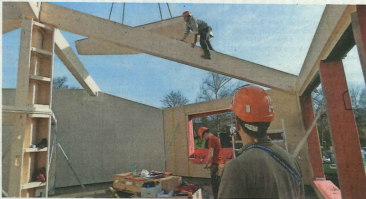
Auf den Balken balancierend setzen die Zimmerleute die Vorfabrikate ein, aus denen das Dach entsteht.
